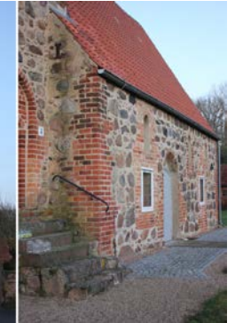
Maria-Magdalena-Kapelle Luckau, Ansicht von Südwesten, gotischer Feldsteinbau. Salzausblühungen in der Süd-West-Ecke des Innenraums.
