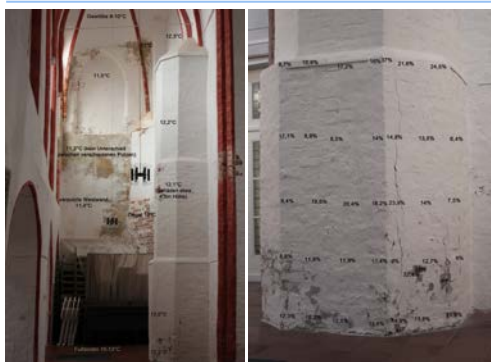
Darstellung der Ergebnisse der Infrarotthermografie in der Süd-West-Ecke (links). Zu erkennen ist auch die Nutzung dieser Ecke als Stuhllager mit vorgehängtem Stoff. Messergebnisse der Materialfeuchtesonde am südlichen Turmpfeiler (rechts). Bei Baustoffen wird von einem Basiswert von 2,5% ausgegangen. Auffällig sind höhere Werte entlang von Rissen oder Kanten.
